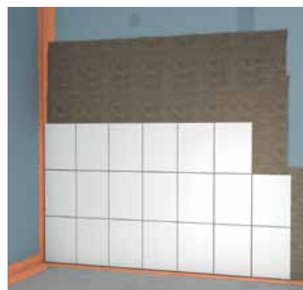
Obrázek 4: Keramický obklad do tenkého lože z flexibilního lepidla fermacell bez celoplošné aplikace těsnícího systému (platí pro třídu zatížení vlhkostí A0, viz. tabulka str. 32).
