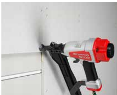
Přídavná vrstva sádrovláknité desky fermacell® nebo Powerpanel H 2 O včetně vytvoření spár
